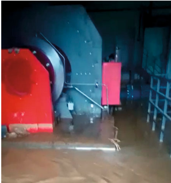
Рис. 1. Дренажная вода из люка для осмотра напорного водовода поступает в машинный зал
