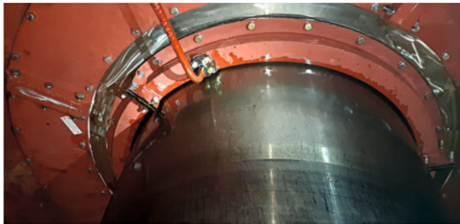
Рис. 15. Дно нижнего генераторного подшипника со следами протечек турбинного масла
