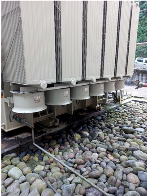
Рис. 8. Следы трансформаторного масла под блочным трансформатором
