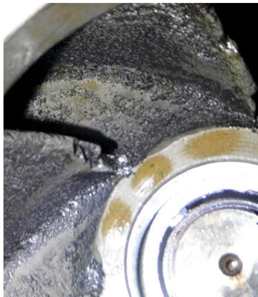
Рис. 6. Масляный циркуляционный насос с видимыми дефектами литья крыльчатки системы охлаждения масла блочного трансформатора
