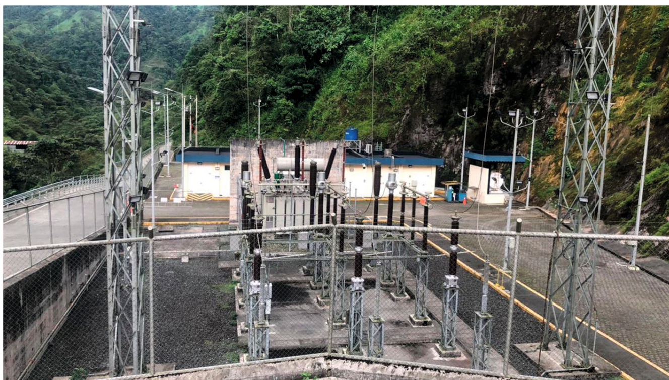
Рис. 7. Электрическая подстанция 230 кВ
