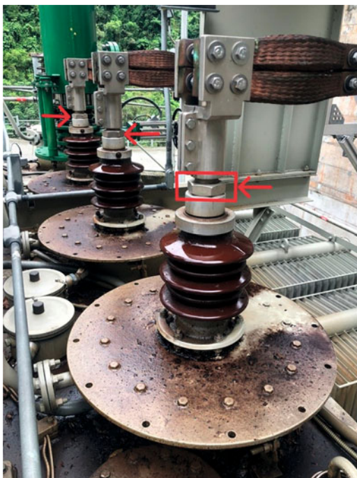
Рис. 9. Вводы 13,8 кВ блочного трансформатора 13,8/230 кВ, протечки трансформаторного масла из-за слабо обтянутых гаек вводов 13,8 кВ (указаны красными стрелками)
