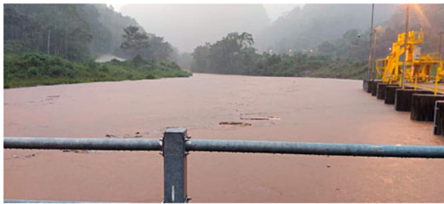
Рис. 3. Вид на верхний бьеф перед водозабором отстойника, сороудерживающие решетки, решеткоочистная машина и плоские затворы на входе в отстойник
