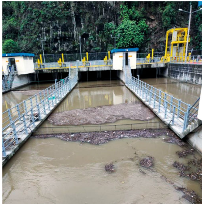
Рис. 4. Отстойник с плоскими затворами на входе
