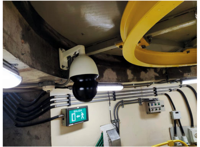
Рис. 10. Шахта гидротурбины со следами протечек турбинного масла из нижнего генераторного подшипника на бетоне
